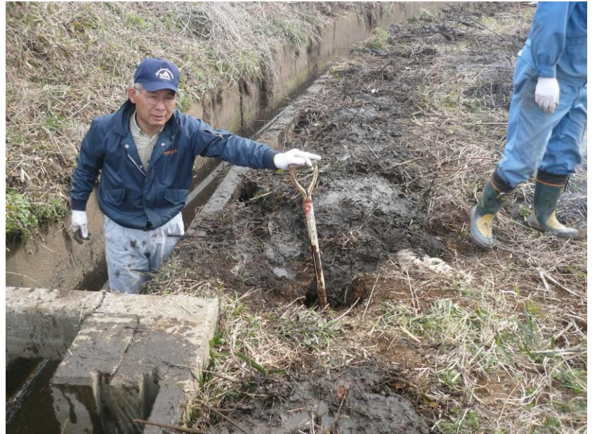
△ 4月5日、年度当初恒例の板倉堰水路泥上げ(今年も泥だらけ。「水路脇こんなに穴が開いちゃってるよ。直さないといけないねえ。」)
